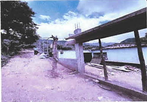
FOTO 1: Sustrucion de Porton de malla en mal estado
